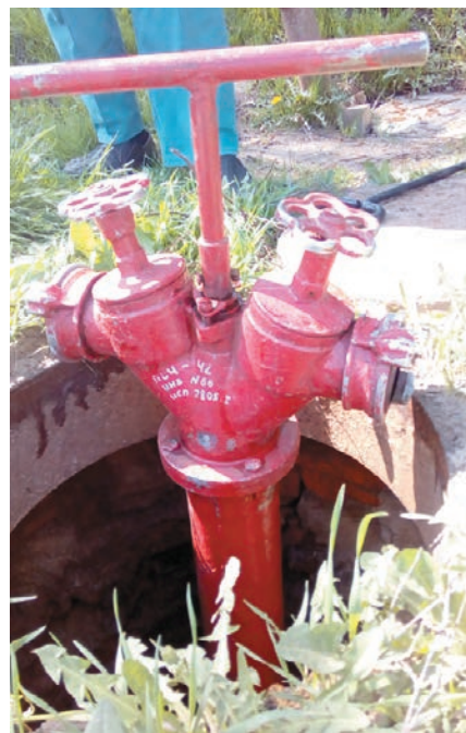
К гидранту на ул. Веденева, 33, в Козельске пожарные рукава подсоединить невозможно.
